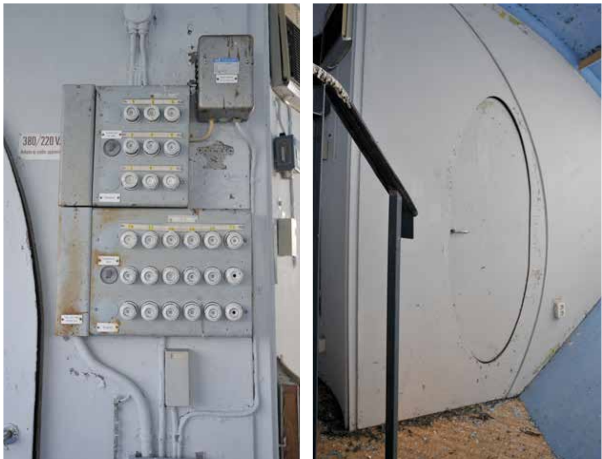
Bild 47 & 48. Mättorn nr 2 på Noran vid Tönnebro. T.V Elcentral med porslins säkringar (diazedsäkringar). T. H oval dörr och utanpåliggande eluttag.
