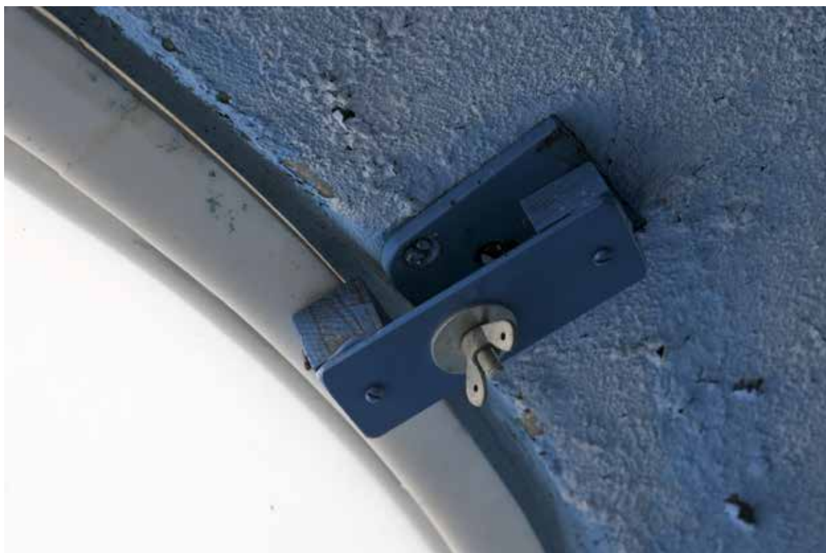
Bild 44. Mättorn nr 2 på Noran vid Tönnebro. Vingmutter som håller fast ett fönster. Troligen togs fönsterglasen bort vid mätningarna för bättre sikt.
