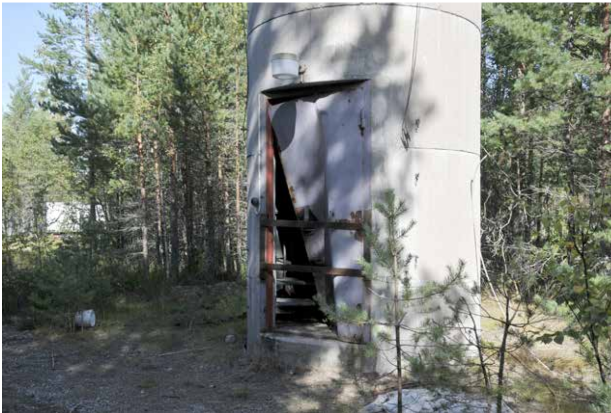
Bild 29. Mättorn nr 2 på Noran vid Tönnebro. Den igensatta dörren har skadats, vilket möjliggjorde inträde vid dokumentationen.
