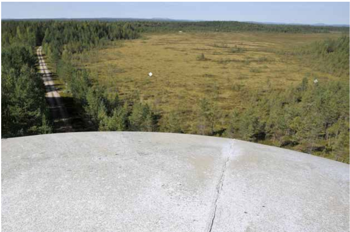
Bild 43. Mättorn nr 2 på Noran vid Tönnebro. Utsikt från taket. Skarvarna mellan futurohusets delar syns som sprickbildningar i takytan.
